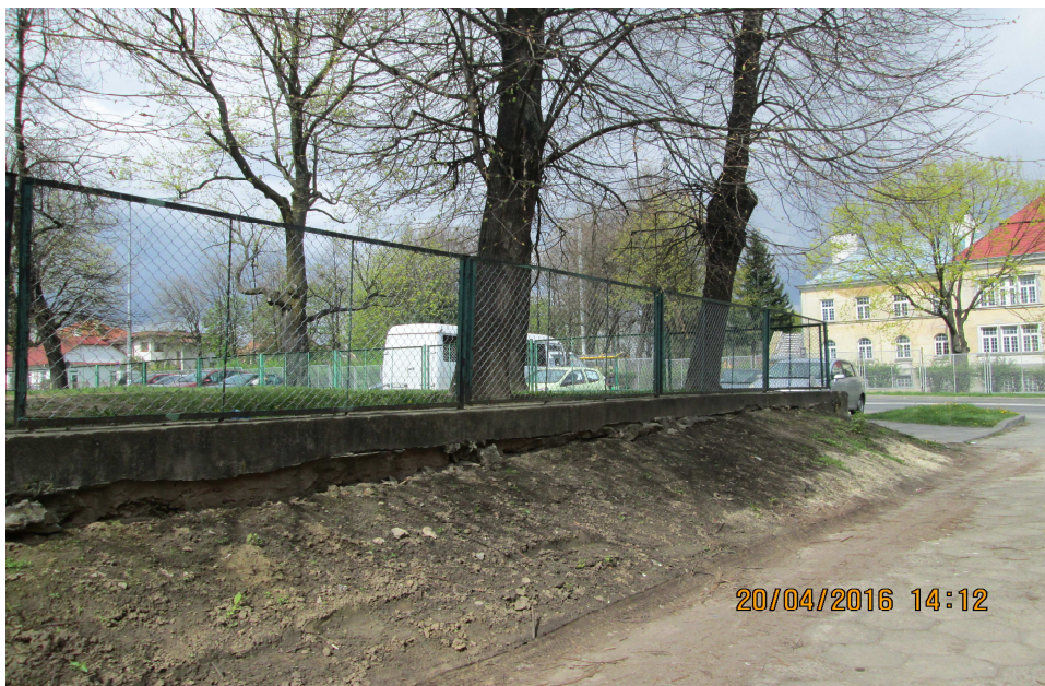
Obsypanie ziemi i spękanie muru ogrodzeniowego na odc..24,80m
