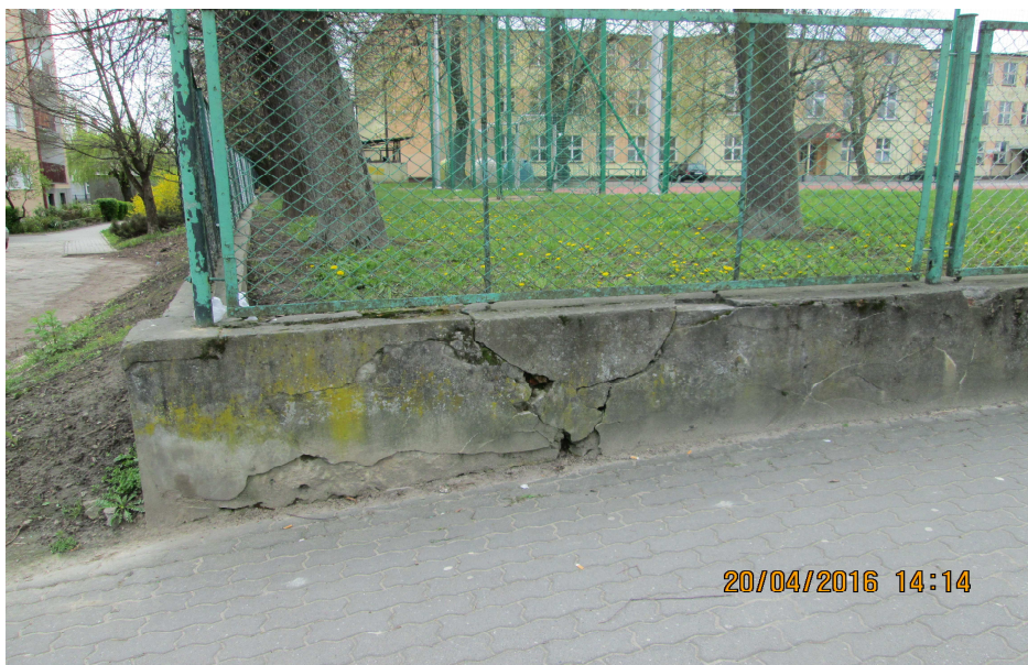
Spękany mur ogrodzeniowy w narożu północno wschodnim
